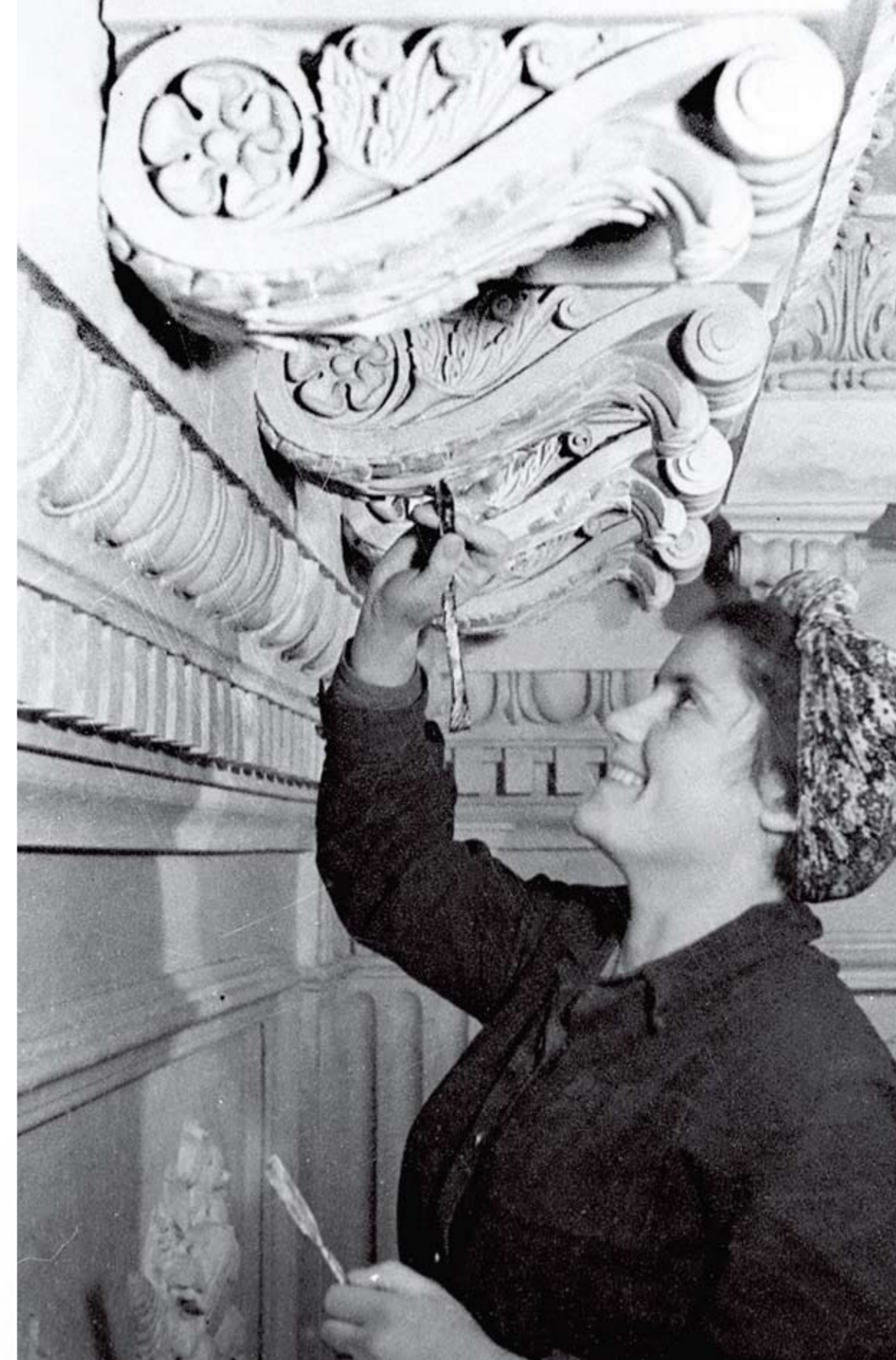
Адзелка ляпнінай інтэр'ераў драматычнага тэатра ў Гомелі. 13 сакавіка 1952 г. Отделка лепниной интерьеров драматического театра в Гомеле. 13 марта 1952 г. Finishing of the interior of the drama theater in Gomel, 13 March 1952
