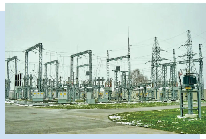
Ввод подстанции «Береза» повысит надежность электроснабжения в районе
