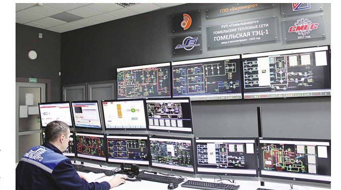
Щит управления Гомельской ТЭС-1
