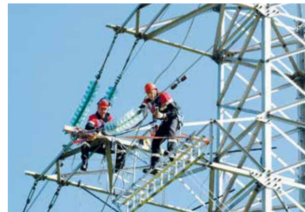
Новые линии электропередачи
